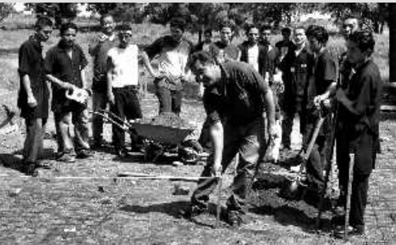
Im Mai hatte Ausbilder Mario Martínez Manzanares zusammen mit den beteiligten Auszubildenden das Fundament gelegt.
